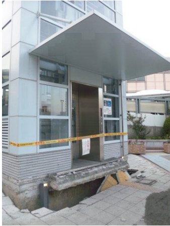
段差・亀裂の入った JR 新浦安駅前エバ-ター
