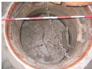
土砂流入による枝管の閉塞状況
