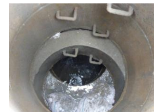
マンホール躯体のずれ
